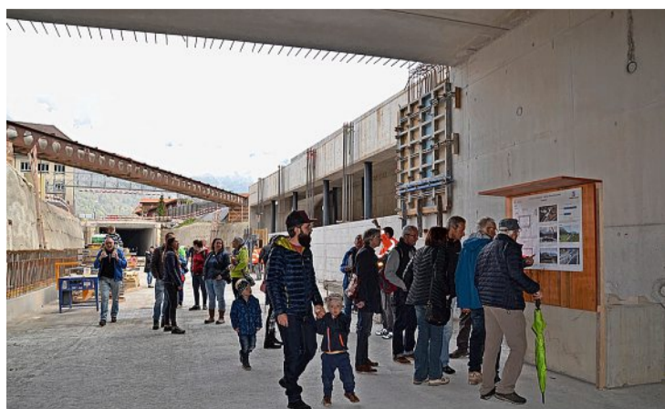
Zahlreiche Interessierte besichtigten die Baustelle der Umfahrung Wilderswil und konsultierten die Informationstafeln. Foto: Monika Hartig
